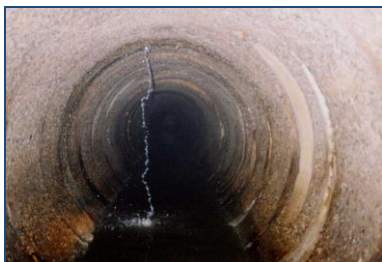
<写真1：漏水した老朽管>
