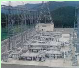
豊根SW/S 550kV GIS
